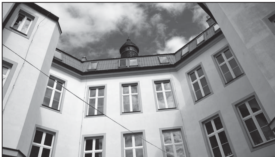
Před nástupem dětí do školy byla dokončena výměna 45 velkých oken v hlavní budově.
