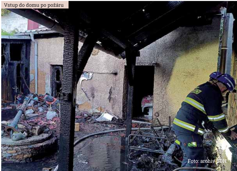
Vstup do domu po požáru
