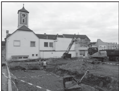
Snímek dokumentuje probíhající stavební práce na místě za městskou radnicí, kde má vzniknout nové parkoviště.
