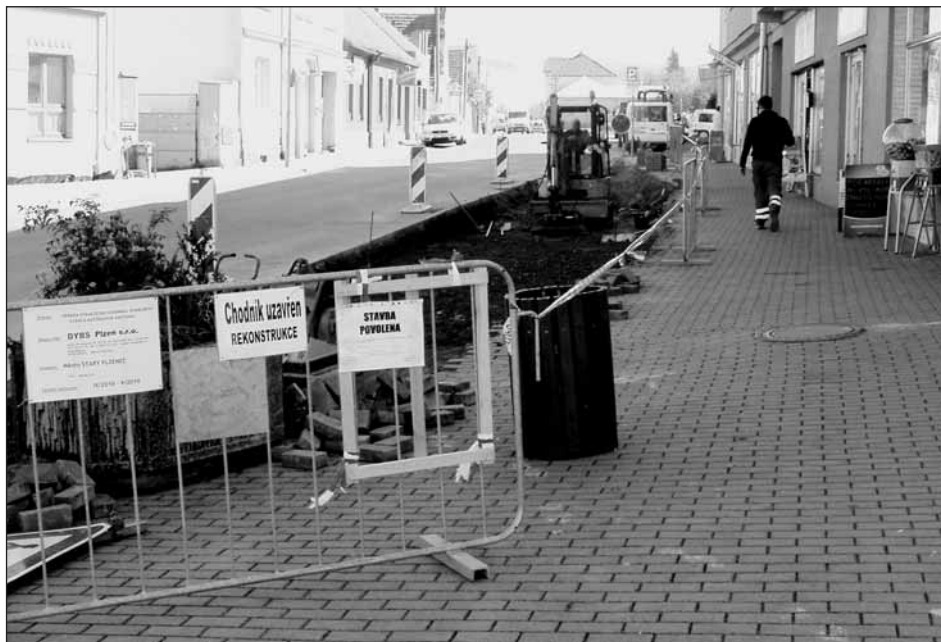
Probíhající rekonstrukční práce na přeložce autobusové zastávky ve Smetanově ulici. Foto Eva Vlachová
